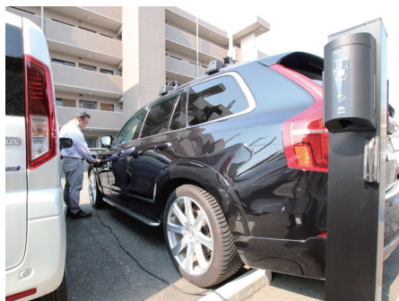
EV充電サービス「WeCharge」を導入したリファレンス物件の一例。
